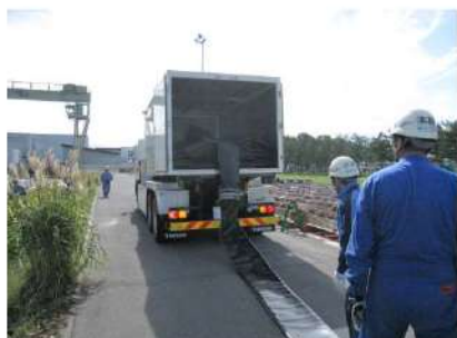
ホース延長・回収車(放水砲用)による ホース敷設 (屋外)
