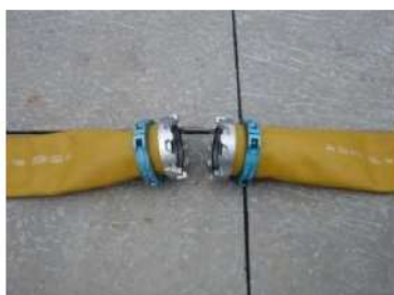
可搬型ホース(150A)接続前
