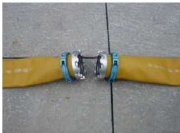
可搬型ホース(150A)接続前
