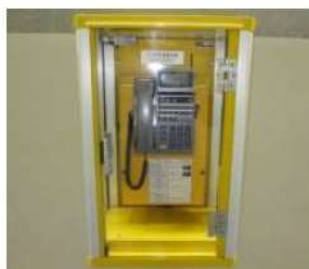
運転指令設備（警報装置を含む）
