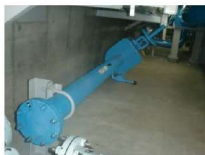
【図3 原子炉補機冷却水系の可搬型ホース接続口】
