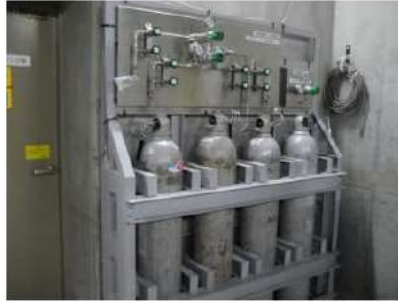
【図1 原子炉補機冷却水サージタンク加圧用可搬型窒素ガスボンベ】
