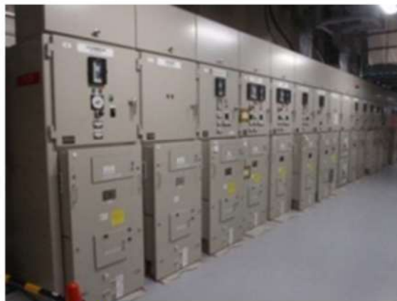
第 1-28 図：3A-安全補機開閉器室の状況
