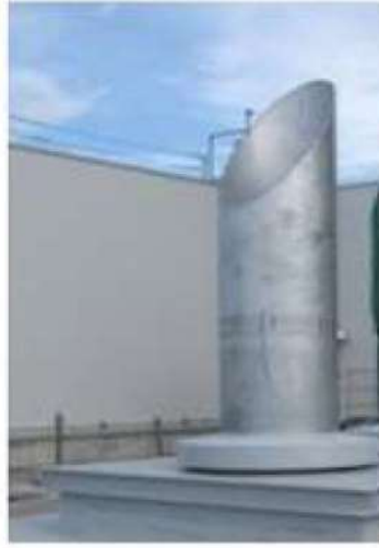
第3図 主蒸気安全弁排気管の設置状況
