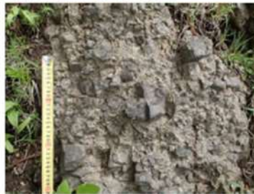
P6 防災科研調査において地滑り土塊北側端部とされる箇所付近の露岩状況 堅硬な岩盤(凝灰角礫岩)が認められる。
