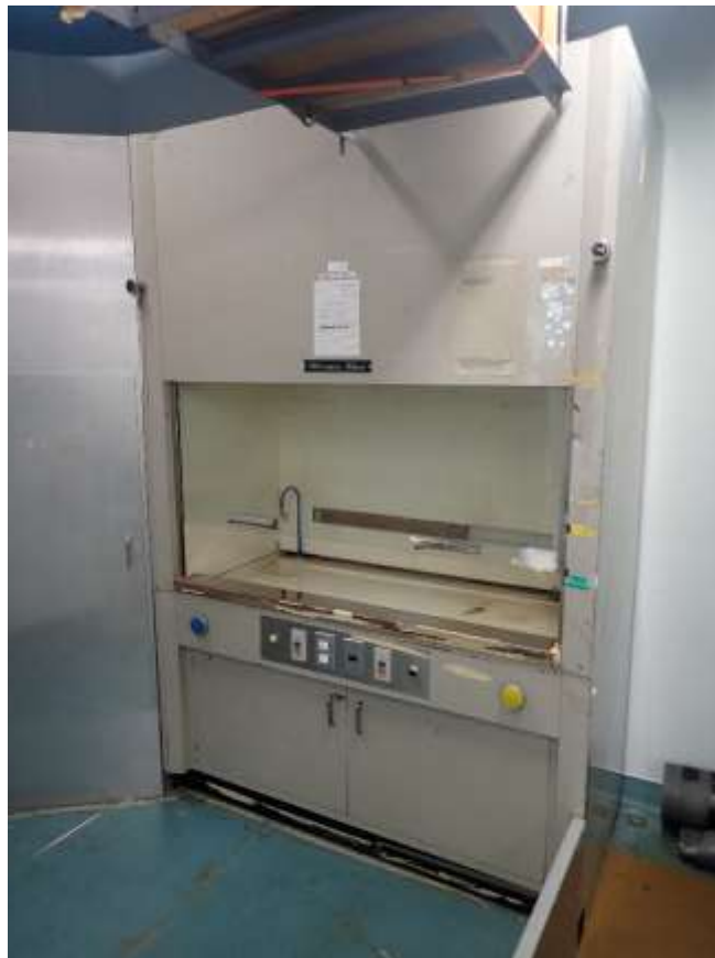
図-3-15 フード H-2 の外観
