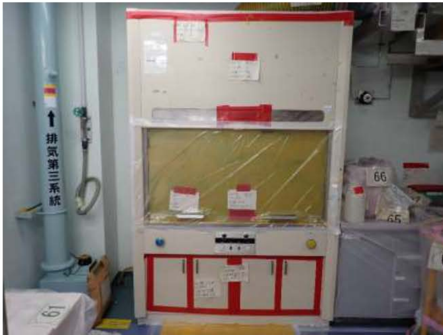
図-3-14 フード H-1 の外観
