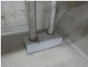
電線管貫通部
