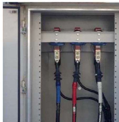
ボルト・ネジ接続 (代替交流電源)
