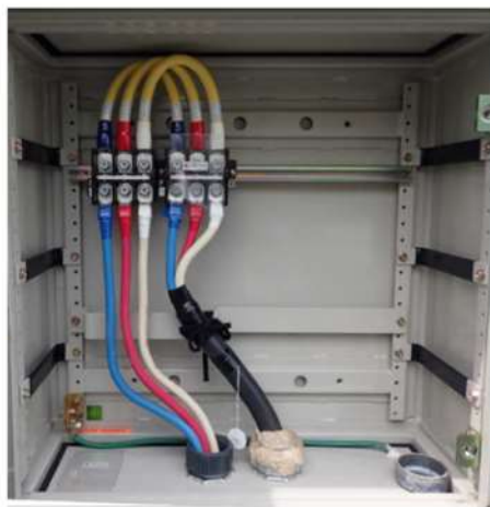
ボルト・ネジ接続 (代替直流電源)
