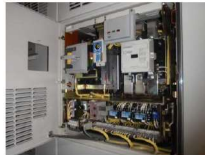
パワーコントロールセンタ
