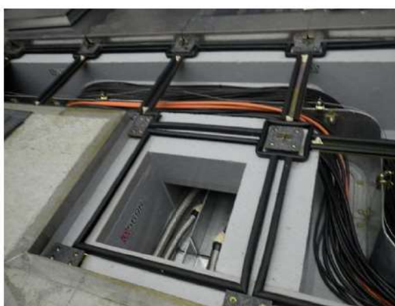
第 41-1-26 図：フロアケーブルダクトの状況
