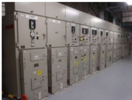
第 1-26 図：3A-安全補機開閉器室の状況
