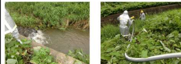
図2-27 消防自動車による予防散水
