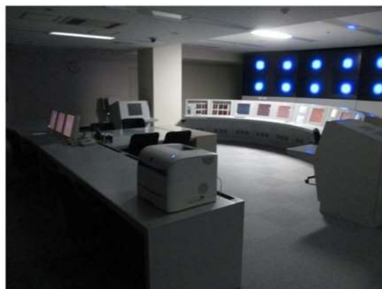
無停電運転保安灯点灯時
