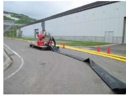
放水砲設置 (屋外)
