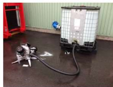
小型放水砲及び泡消火薬剤
