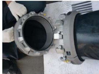
可搬型ホース(300A)接続
