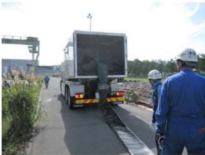
ホース延長・回収車（放水砲用） による可搬型ホース敷設 (屋外)
