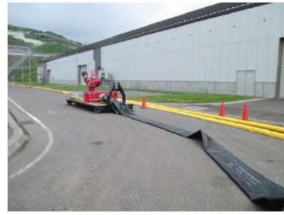
放水砲設置 (屋外)
