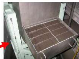
触媒プレート収納部
