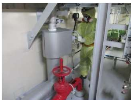
可搬型大型送水ポンプ車による原子炉格納容器下部への注水系統構成 （運転員（現場）B） （原子炉補助建屋 T. P. 10. 3m）
