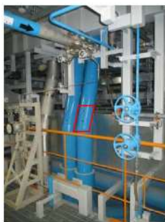
可搬型温度計測装置（格納容器再循環ユニット入口温度／出口温度）設置場所（供給側） (周辺補機棟 T. P. 10.3m（中間床）)
