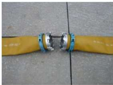
可搬型ホース（150A）接続前
