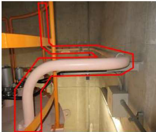
ディーゼル発電機燃料油サービスタンク 燃料油ベントライン (燃料油サービスタンク周辺敷設状況)
