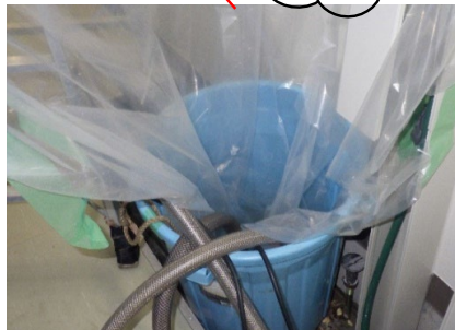
雨水の集水状況
