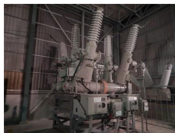
(b) 66kV 開閉所（屋内）
