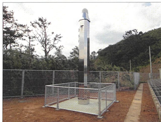
黒島の機器設置状況
