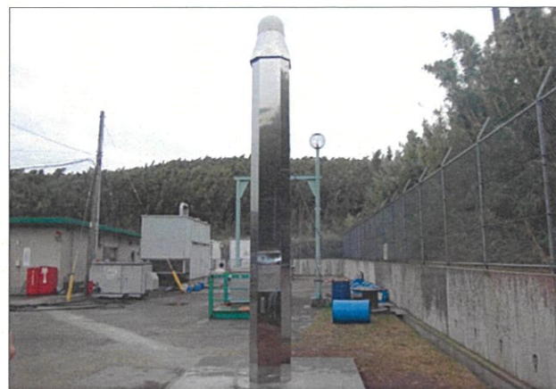
竹島の機器設置状況
