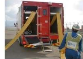
ホース延長・回収車（送水車用）による 可搬型ホース敷設 (屋外 T.P. 33. 1m)
