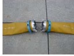
可搬型ホース（150A）接続前
