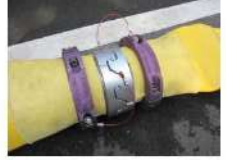
③ 可搬型ホース接続（接続後）
