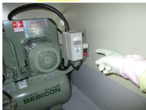
可搬型代替ガスソフリング圧縮装置起動 (周辺補機棟 T. P. 24. 8m)
