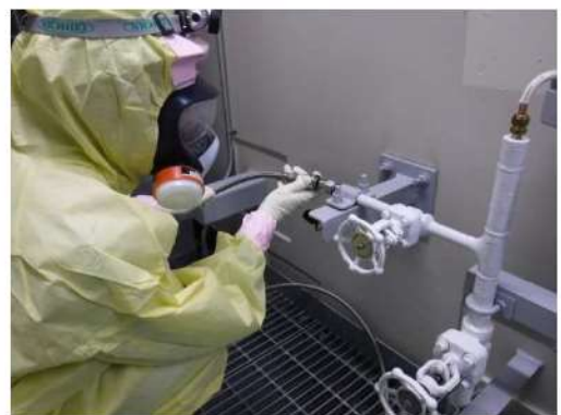
代替空気(窒素)供給用フレキシブル配管接続 (周辺補機棟 T. P. 21. 2m)
