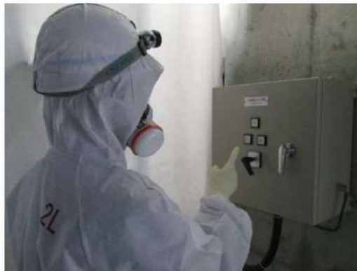
代替格納容器スプレイポンプ起動操作 （周辺補機棟 T.P. 10.3m）
