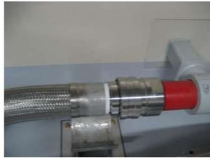
消火水系配管と 格納容器スプレイ系配管との 接続のための可搬型ホース接続後 (運転員(現場) B) (原子炉補助建屋 T. P. 10. 3m)
