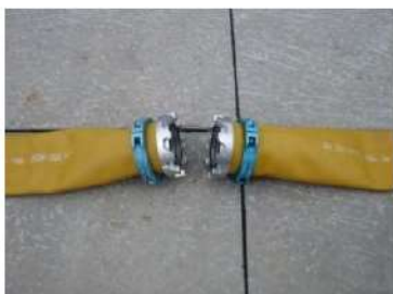
可搬型ホース(150A) 接続前
