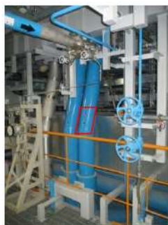
可搬型温度計測装置（格納容器再循環ユニット入口温度／出口温度）設置場所（供給側） (周辺補機棟 T. P. 14. 3m)
