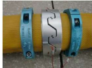
可搬型ホース(150A)接続後
