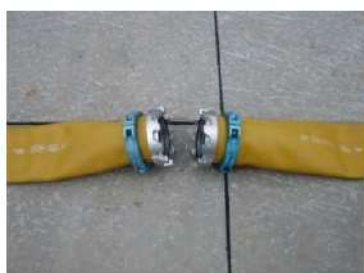
可搬型ホース（150A）接続前
