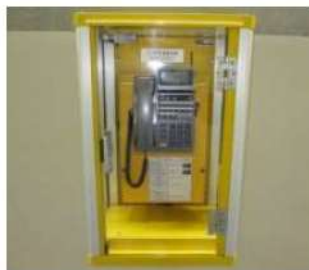
運転指令設備（警報装置を含む）
