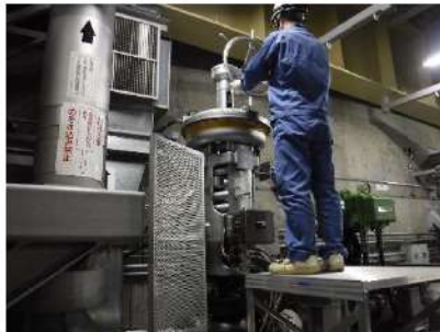
【図3 3B-主蒸気逃がし弁操作風景】
