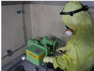
【図3 3B-1次冷却材ポンプ封水注入ラインC/V外側隔離弁操作風景】
