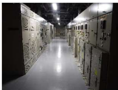
【図1 3B-安全補機開閉器室】
