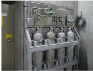
【図1 原子炉補機冷却水サージタンク加圧用可搬型窒素ガスボンベ】
