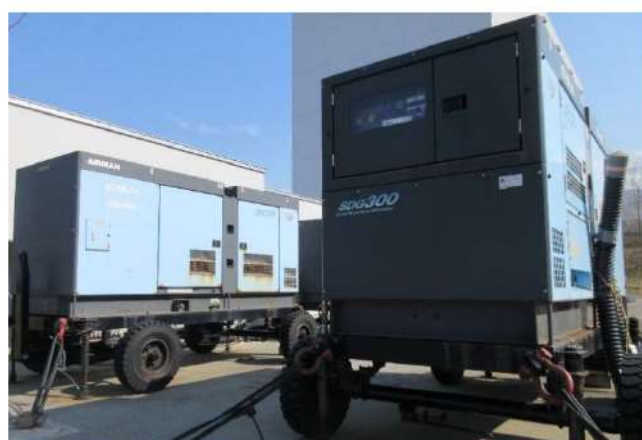
図4-11 緊急時対策所用発電機 外観
