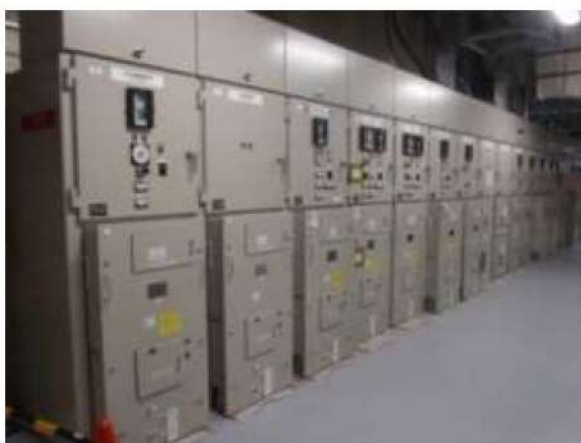
第 41-1-25 図：3A-安全補機開閉器室の状況
