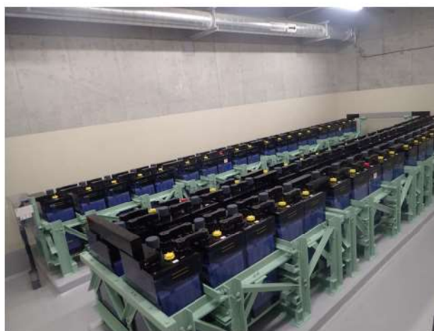
第 41-1-26 図：常用系蓄電池室の状況
