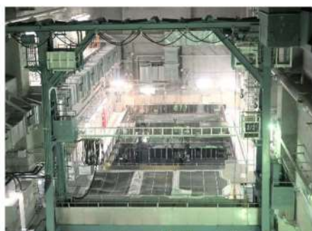
使用済燃料ピットクレーン
