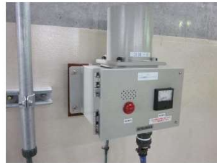
機器の固定状況
