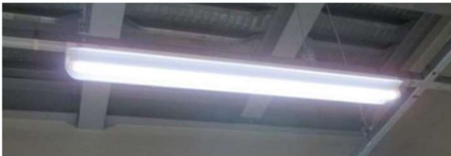
無停電運転保安灯
