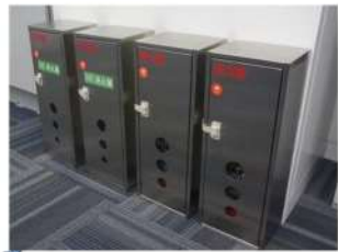
消火器の設置状況
