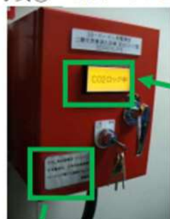
写真③ 放出ロック盤
