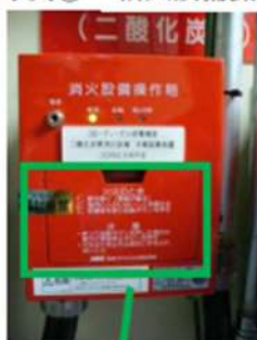
写真⑤ 消火設備操作箱
