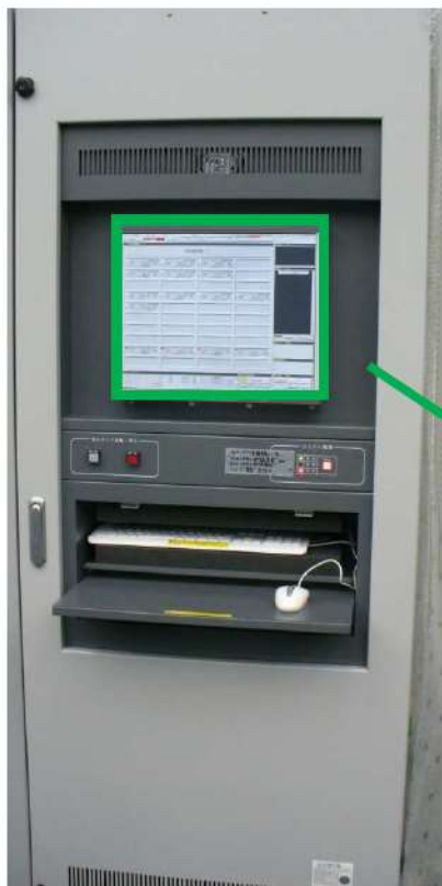
写真④ 中央制御室 総合操作盤
