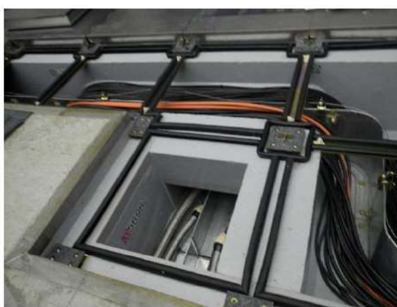
第 41-1-24 図：フロアケーブルダクトの状況
