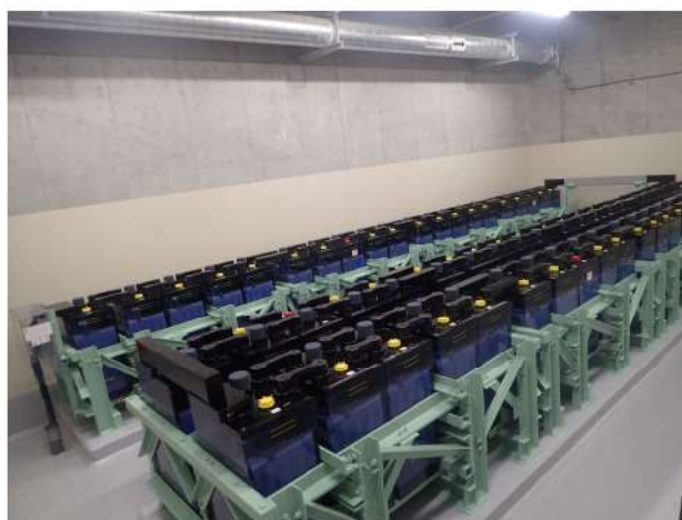
第 41-1-26 図：常用系蓄電池室の状況
