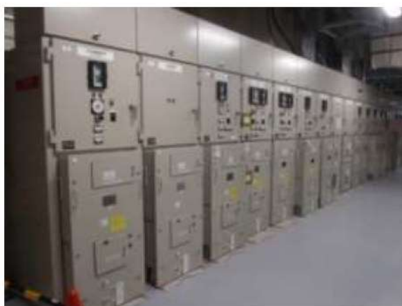
第 41-1-25 図：3A-安全補機開閉器室の状況
