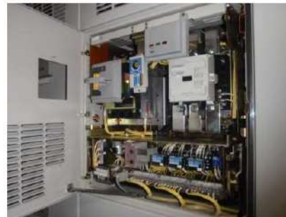
パワーコントロールセンタ
