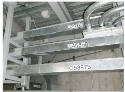
ケーブルトレイ，電線管の例
