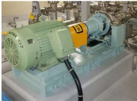
ポンプ，配管，支持構造物の例
