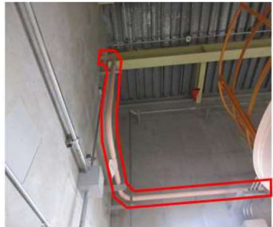
ディーゼル発電機燃料油サービスタンク 燃料油ベントライン (原子炉建屋敷設状況)
