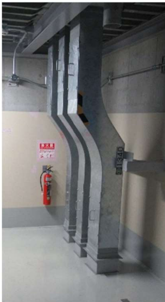
第 2-1 図 ケーブルトレイ床貫通部外観
