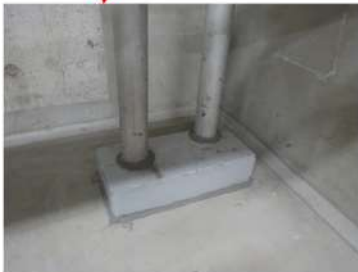
電線管貫通部
