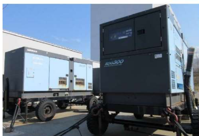
図4-11 緊急時対策所用発電機 外観
