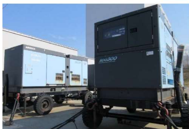
図4-11 緊急時対策所用発電機 外観
