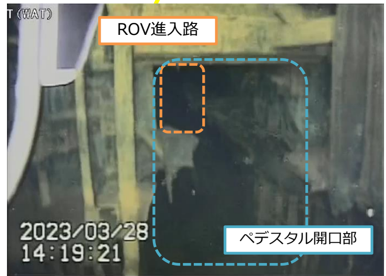
写真3.ペDESTAL開口部
