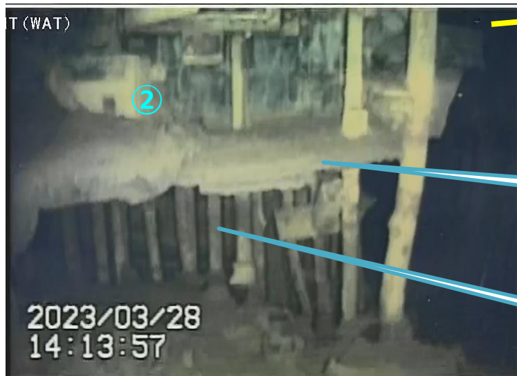
写真2.ペDESTAL開口部左下側壁面部
