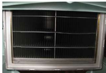
装置底部 (PAR 入口給気口)
