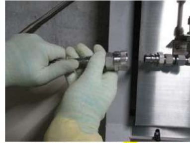
アニュラス全量排気弁等操作用可搬型窒素ガスポンペのカブラ接続
