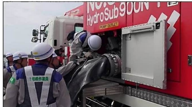
◇移動式大容量ポンプ車の設置
