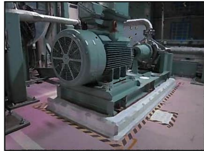
常設電動注入ポンプ
