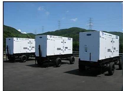
直流電源用発電機
