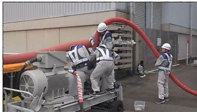
◇可搬型電動低圧注入ポンプの設置
