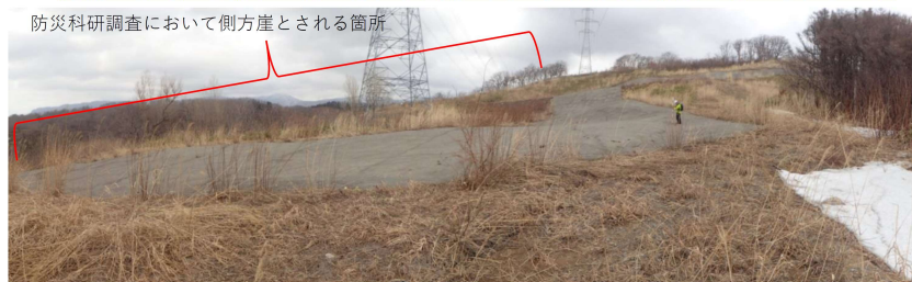
防災科研調査において側方崖とされる箇所 P3 防災科研調査において側方崖とされる斜面の状況 側方崖を示唆する遷急線及び遷緩線は認められない。
