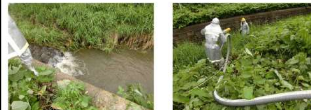
図2-27 消防自動車による予防散水
