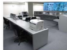
通常点灯時 (運転係員灯及び無停電運転係員灯)
