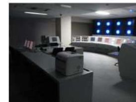
無停電運転係員灯点灯時
