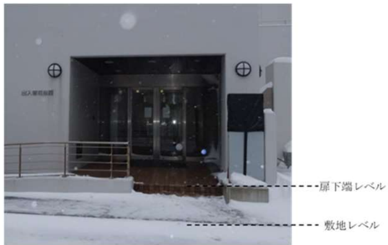
図3 建屋外壁扉 (代表例)
