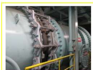
循環水管伸縮継手
