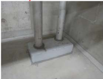
電線管貫通部
